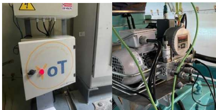
Figura 5 – Painel IIOT e Skid de sensores [Autores].
