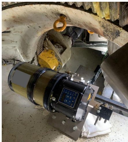
Figura 4 – Sistema de lubrificação automática instalado no aerogerador
