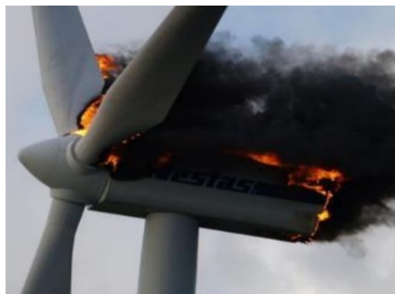
Figura 2 - Incêndio causado por raio
