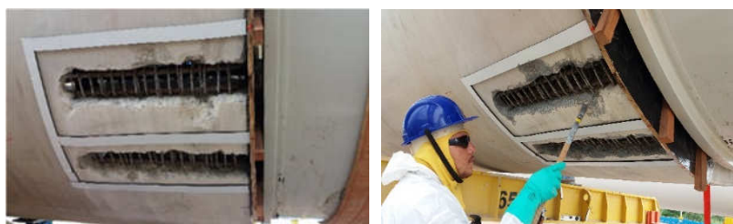
Figuras 17 e 18 – Detalhe fitas de vedação de dupla face à esquerda e aplicação de ponte de aderência à direita (Fonte: Dois A Tower System).
