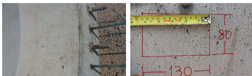
Figuras 9 e 10 – Identificação da área a ser hidrodemolidada (Fonte: Dois A Tower System).
