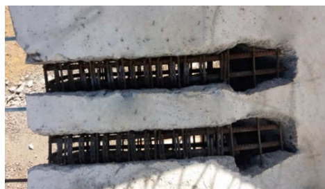
Figura 5 – Detalhe da ferragem íntegra após o corte do concreto (Fonte: Dois A Tower System).
